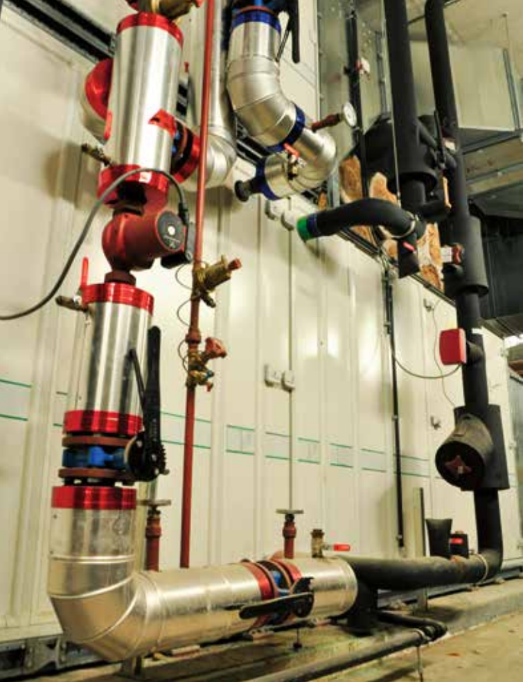
Het ventilatiesysteem in de derde fase kan de verse lucht zowel opwarmen als afkoelen (topkoeling) naargelang het seizoen en de buitentemperaturen.
