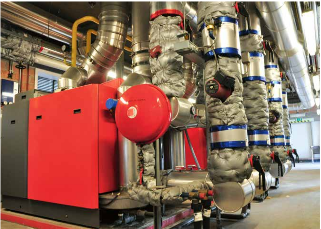
Vier ketels van elk 200 kW staan in voor de verwarming van de eerste twee fases van De Meers
