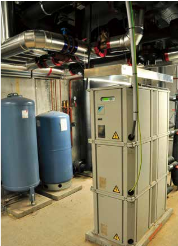
Een warmtepomp (113 kW) in combinatie met het BEO-veld staat in voor de verwarming via vloerverwarming in de winter en topkoeling via ventilatie in de zomer.
