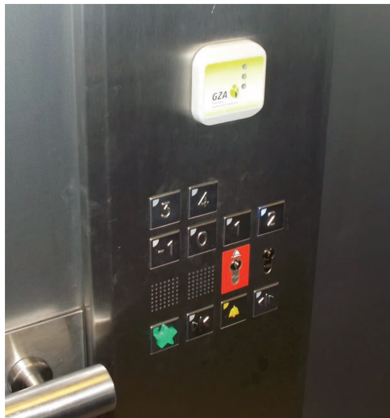
Online systeem: hier toegepast om bepaalde verdiepingen met de lift te kunnen bedienen. Geen badge geeft geen toegang tot bepaalde verdiepingen.
